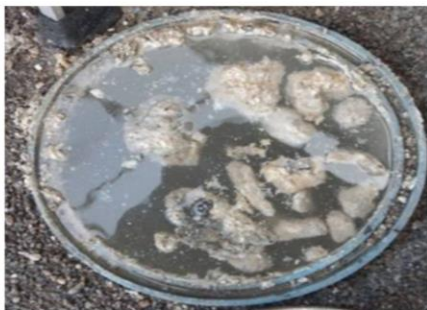
マスが詰り汚水が溢れている状態
